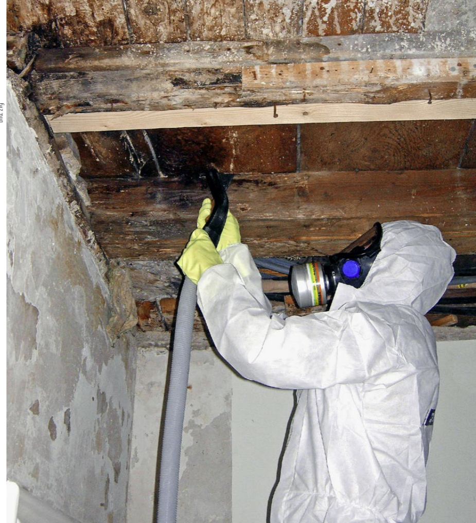
Kaum ein Gebäude älteren Baudatums kann bedenkenlos saniert oder abgebrochen werden. Früher wurden gefährliche Materialien wie Asbest verbaut, die heute als Sondermüll gelten.
