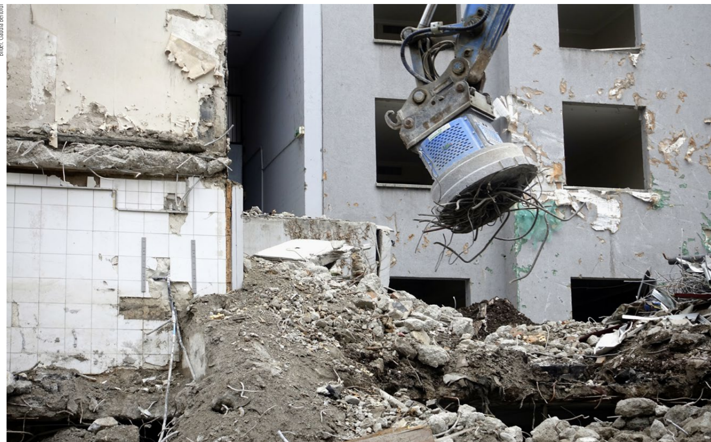
Beim Rückbau ist die Trennung der Materialien gesetzlich vorgeschrieben. Dabei muss immer mit umwelt- oder gesundheitsgefährdenden Stoffen gerechnet werden, was ein Entsorgungskonzept erfordert. Fallen mehr als 200 Kubikmeter Bauabfälle an, ist das Entsorgungskonzept obligatorisch.
