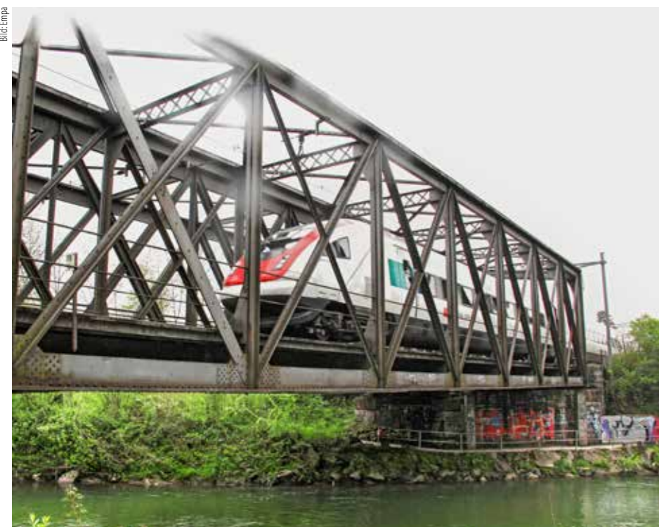
An der Münchensteinbrücke im Kanton Baselland wurden die tragenden Elemente mit vorgespannten, faserverstärkten Kunststofflamellen verstärkt.
