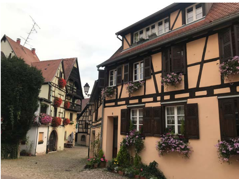
Fachwerk bietet der Feuchtigkeit viele Angriffspunkte, da die Materialien unterschiedlich reagieren.
